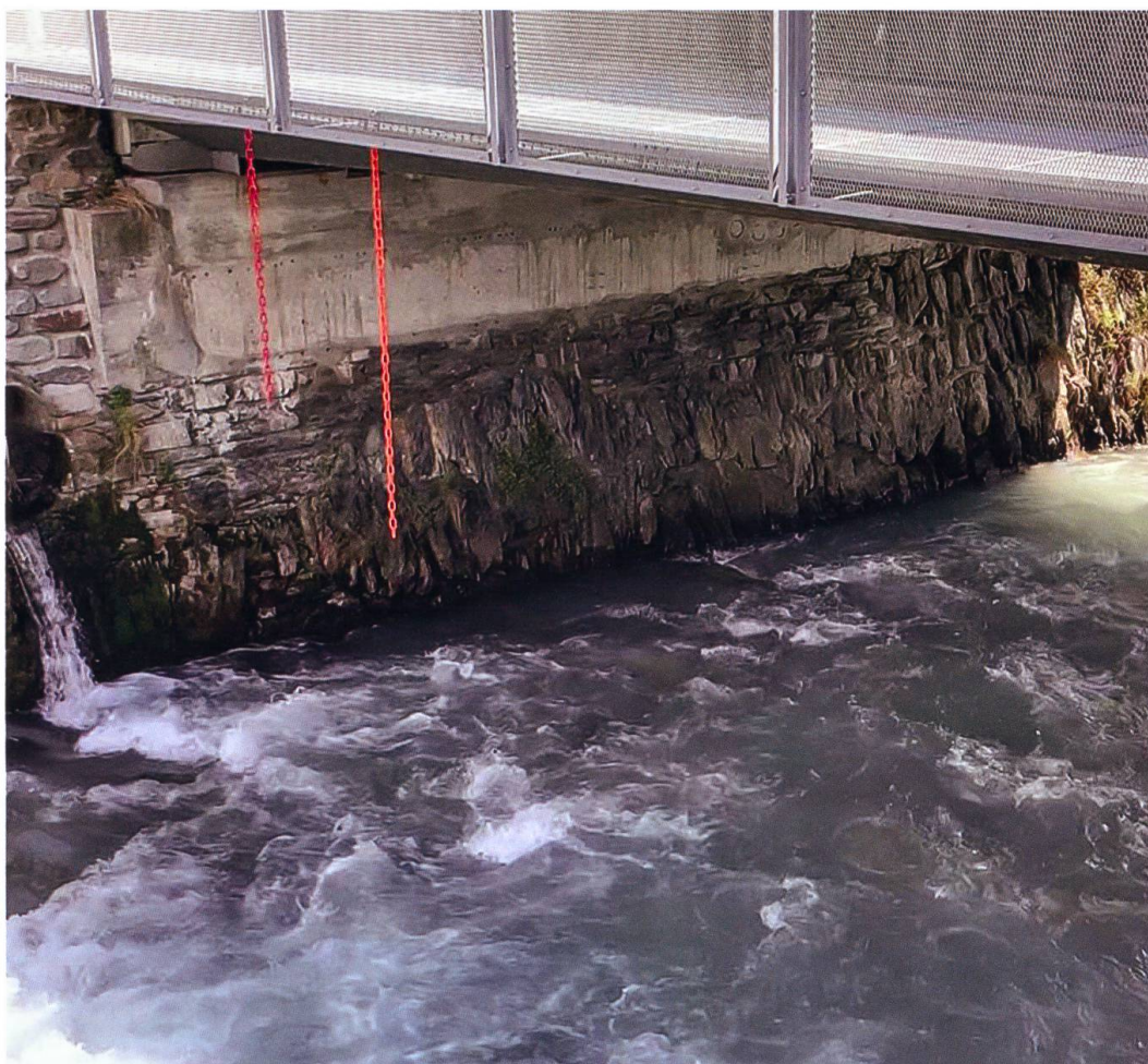
Ponte di Cimavilla, la spalla del ponte mostra l'inadeguata altezza prima dell'alluvione del 1987. Foto: F. Iseppi
