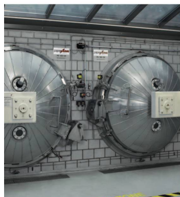
L'installation papersave swiss à Wimmis. Les deux chambres sont fermées: l'installation est en service.
