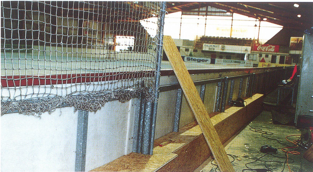
Die Eishalle Bergholz ist dringend sanierungsbedürftig.
