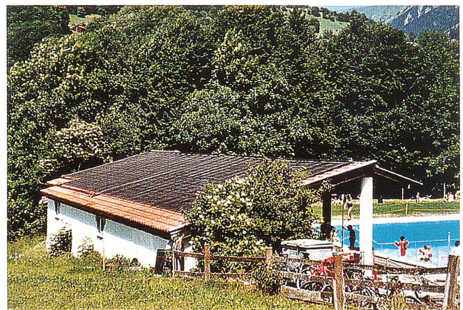
125 m 2 Solarkollektoren auf dem Kabinendach
