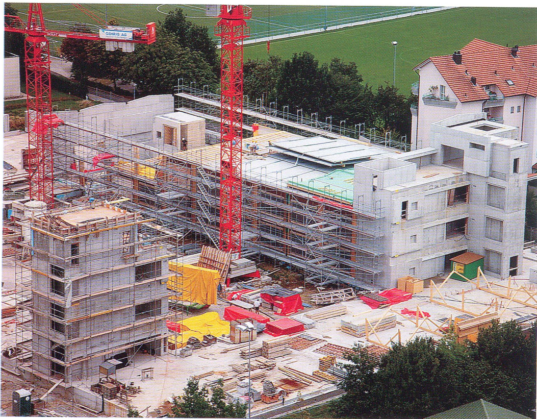
Blick vom Silo auf die Baustelle Kanti Wil: Die Aufrichtearbeiten haben begonnen (Stand Ende August).
