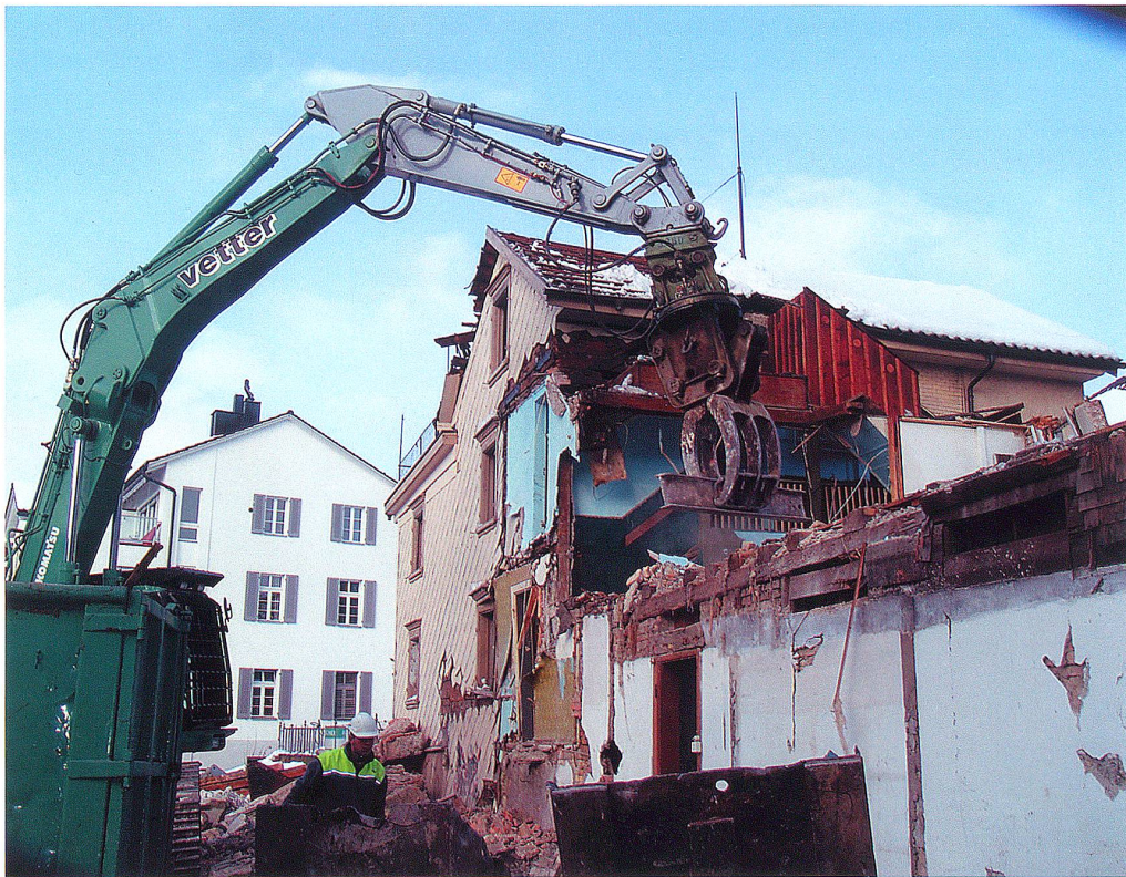
Beim Haus «Sattlerei Vollmar» fuhr Mitte Februar der Abbruchbagger auf. Die Gebäude mussten einem provisorischen Parkplatz weichen.
