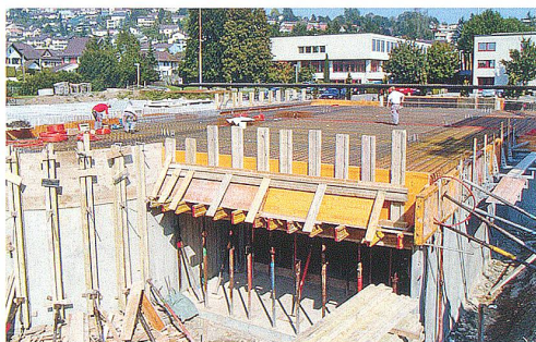
Das Mehrfamilienhaus an der Bronschhoferstrasse mit 10 Eigentumswohnungen und einer Tiefgarage kann Ende April 2006 bezogen werden.
