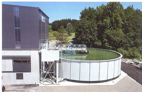
Dank einem geschlossenen Kreislauf kann das Wasser für die Kiesaufbereitung immer wieder verwendet werden. Hier im Bild die Wasseraufbereitungsanlage des Kieswerks.
