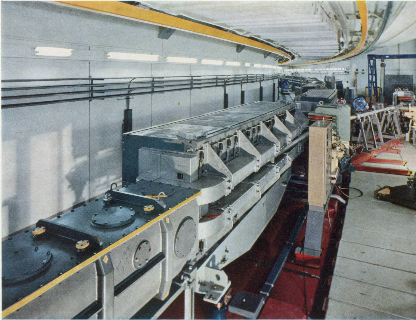
Vue du tunnel circulaire du synchrotron à protons de 25 GeV. On voit, au centre de la figure, l'un des cent éléments de l'électroaimant de guidage dont l'équipement d'alimentation a été construit par la Société Brown Boveri. La photographie a été prise à l'endroit où les protons venant de l'accélérateur linéaire, à droite, sont injectés dans le synchrotron.
