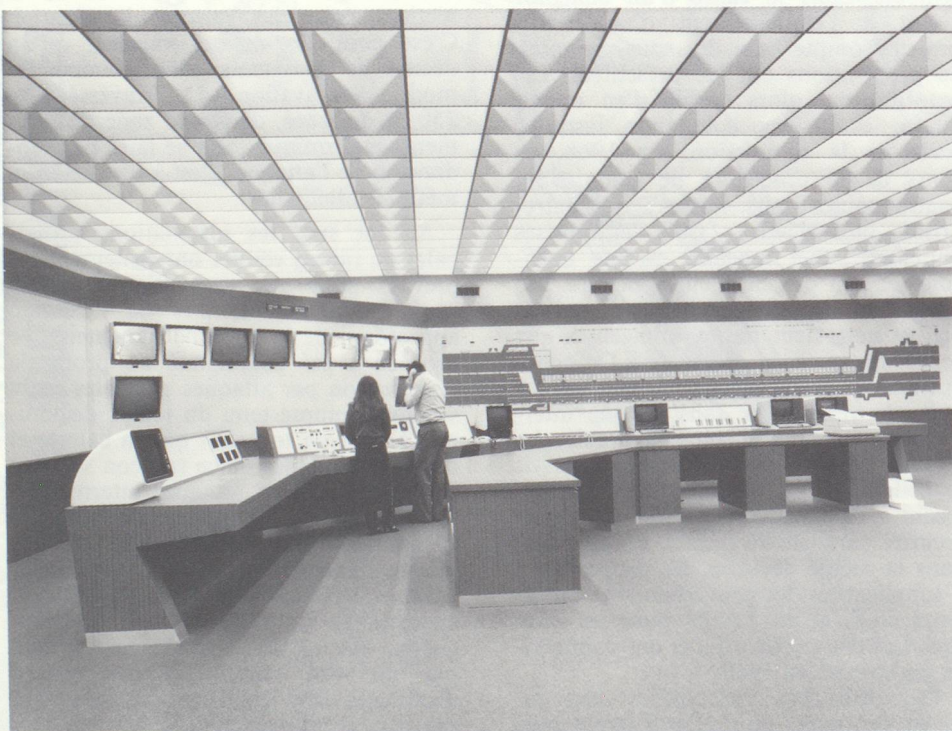
Poste de commandement Nord du tunnel routier du Gothard
