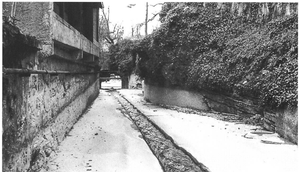
Der Magdenerbach vor der Einmündung in den Rhein vor dem Umbau: ökologisch tote Betonschussrinne (März 1993). Fotos: F. Lüscher
