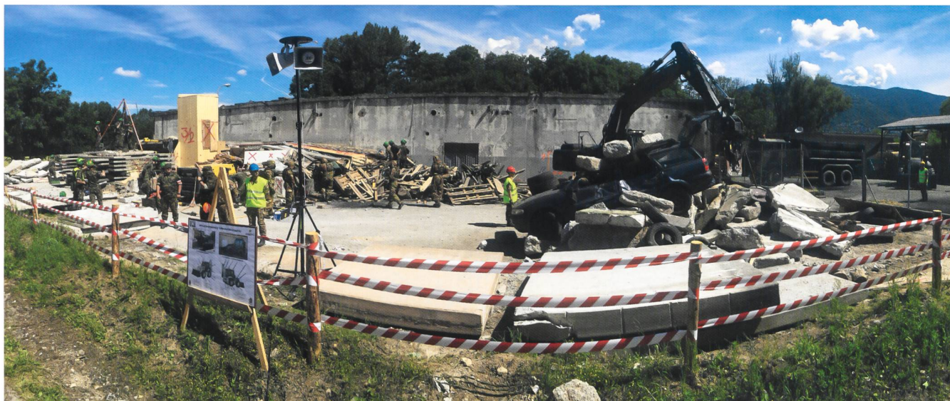
Si lavora alle macerie, si salvano superstiti
