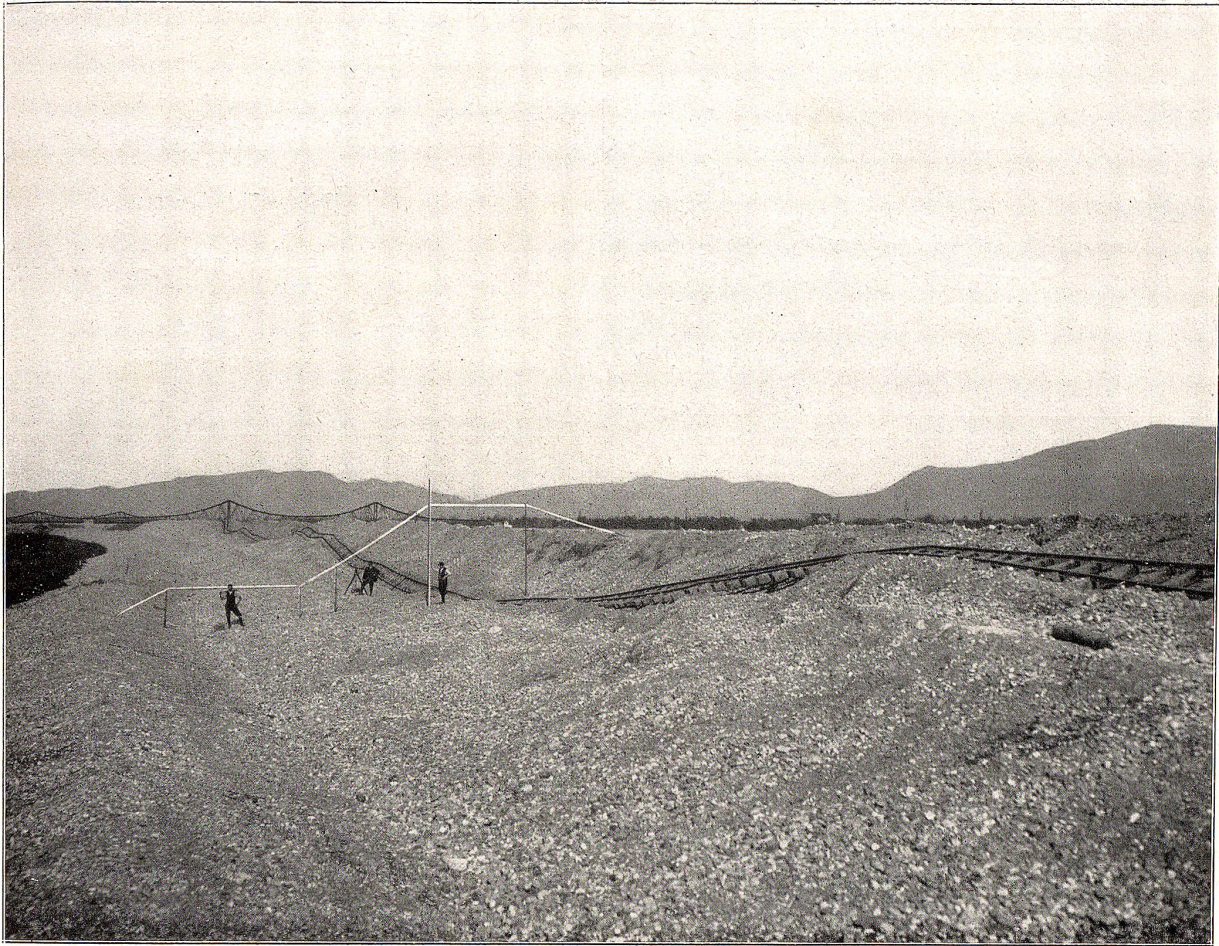
Abbildung 9. Plötzliche Dammsenkung auf der Torfstrecke bei hm 39–42 rechts.
