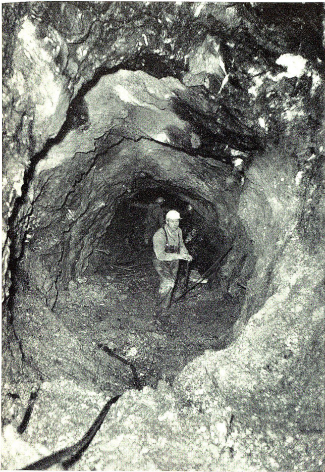
In gefahrvoller, schwerer Arbeit haben die Mineure innert 3 Jahren 34 km solcher Stollen mit einem Durchmesser von 3,20 bis 3,60 m erstellt
