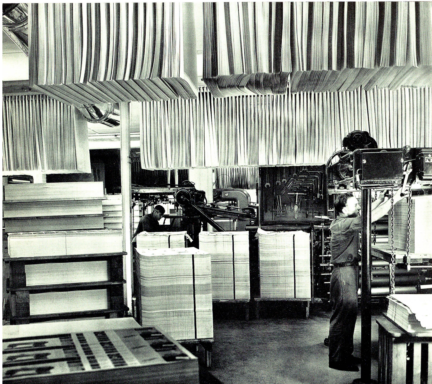
Luftbefeuchtungsanlage zur Akklimatisierung des Druckpapiers
