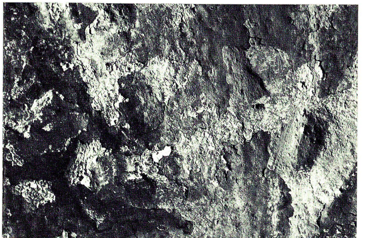
Ein besonders eindrückliches Bild der vor 1975 zerstörten und losen Farbschicht.
