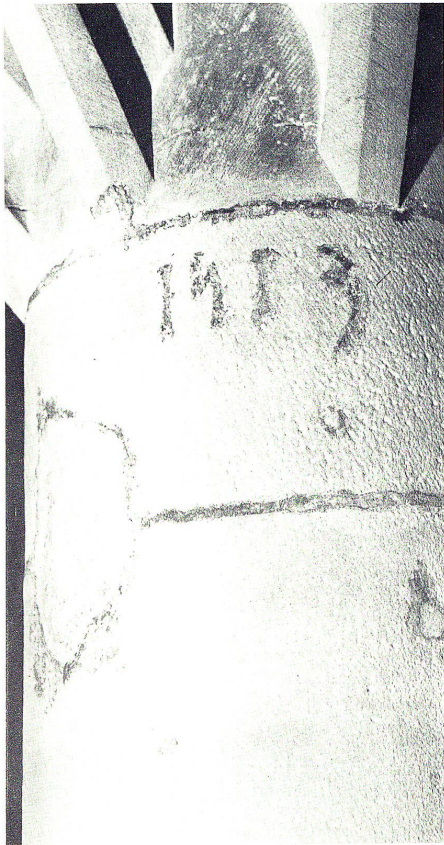
Unsachgemässe Flickarbeiten früherer Jahrzehnte müssen nach den heutigen Richtlinien der Denkmalpflege ersetzt werden.
