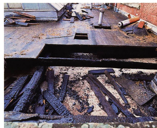
Verkohlttes Gebälk im Zwischenboden des Werkhallendachs
