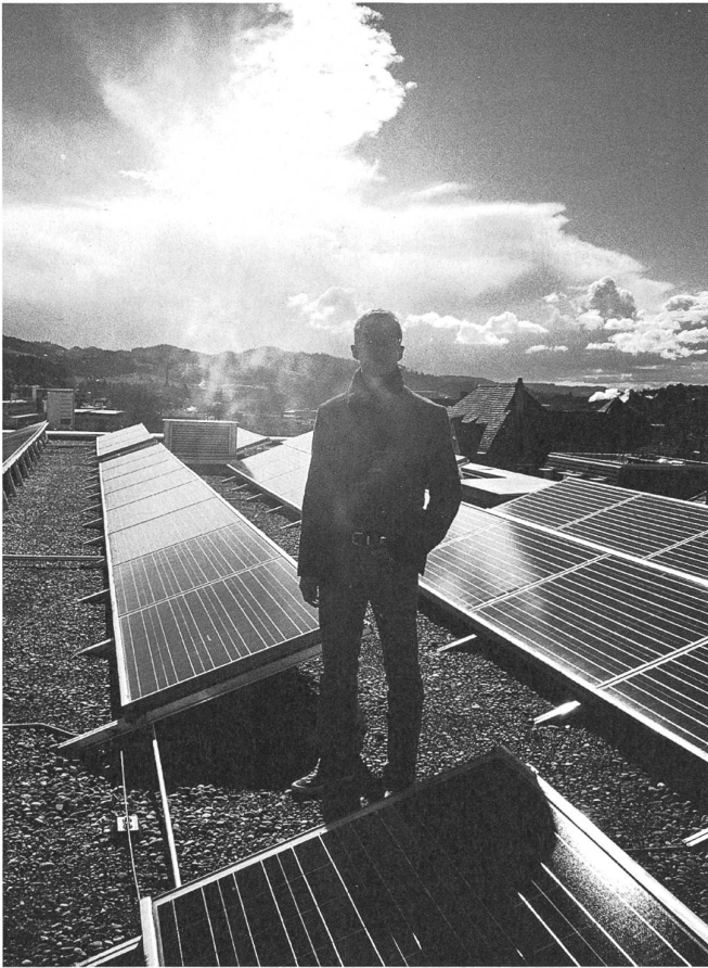
Fredy Zaugg zeigt die Solarpanels auf dem Schulhausdach von Schönenwegen.
