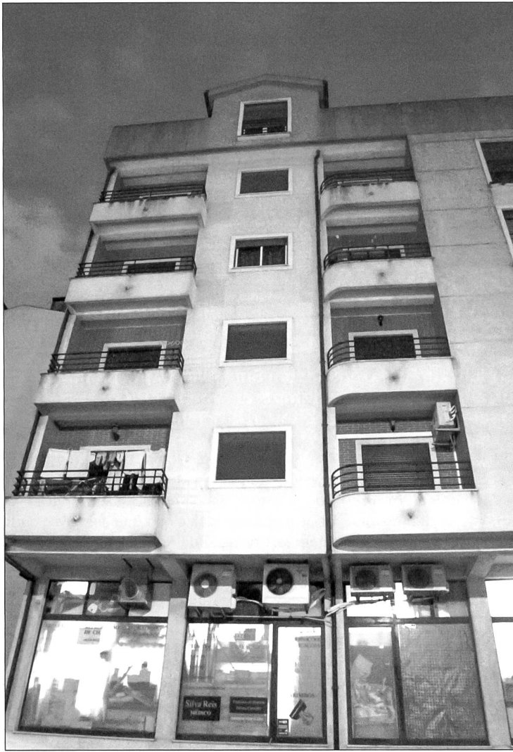
Schnell und billig gebaut: Ein Grossteil der portugiesischen Wohngebäude ist kaum oder gar nicht isoliert.
