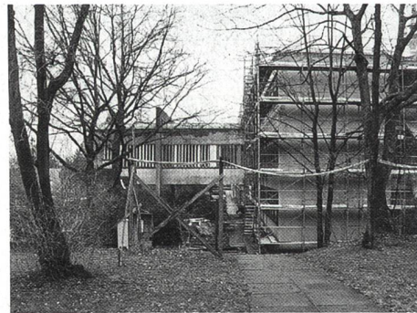
Die Haustechnikanlagen und die Gebäudehülle der Veterinärmedizinischen Fakultät müssen erneuert werden. Auch die neue Raumnutzung erfordert Umbauten. (Bild Zoran Ralievic)
