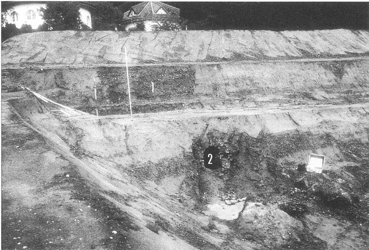
Abb. 8: Deutlich sichtbar im modernen Baugrubenprofil der mit Sickerkies aufgefüllte Grabeneinschnitt (1) über dem Sickerstollen (2) im Sandacker.
