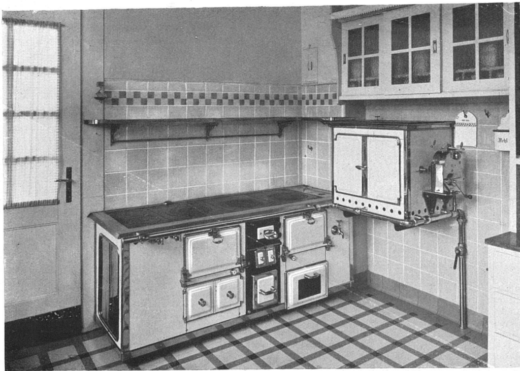
Aus der Küche des Herrn Hofmann in Zürich-Wollishofen. Senking-Herd für Kohle und Gas mit Schränkchen und Kohlenwagen, daneben Spiess- und Grill-Apparat für Gas.
