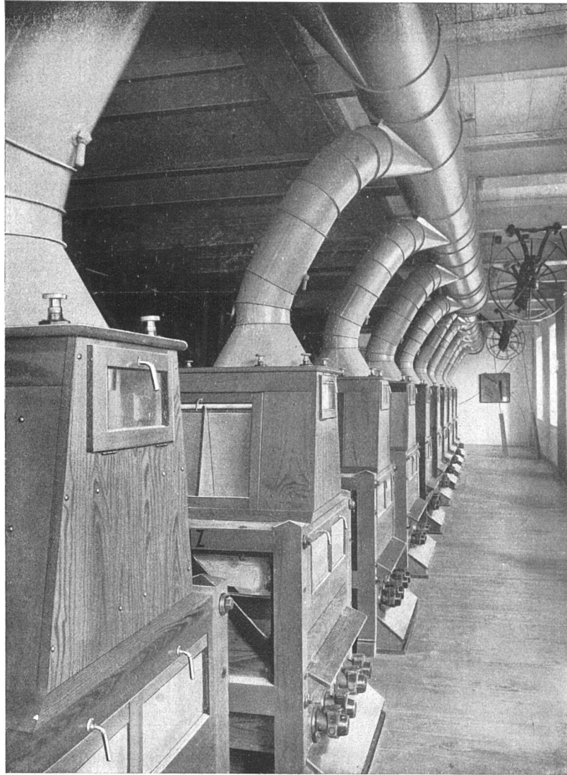
Mühleneubau der Firma Steiners Söhne in Malters. — II. Stock: Boden der Griessputzmaschinen. Architekt: Johann Bucher, Luzern. Maschinelle Installationen: Gebrüder Bühler, Maschinenfabrik, Uzwil.
