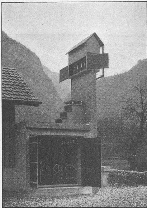
Fig. 17. Transformatoren-Station bei Dallenwyl.
