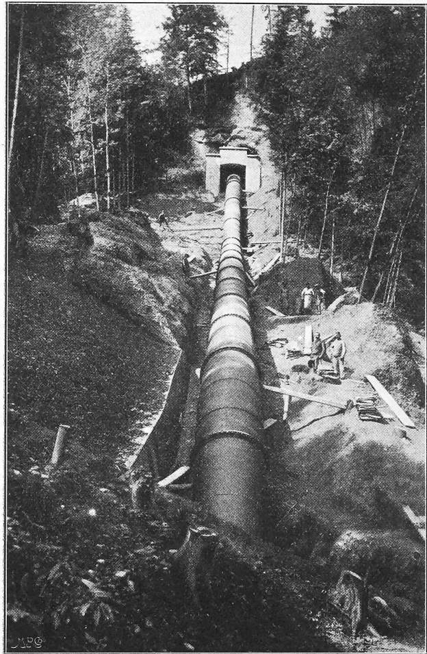
Abb. 30. Mittlerer Teil der Druckleitung.
