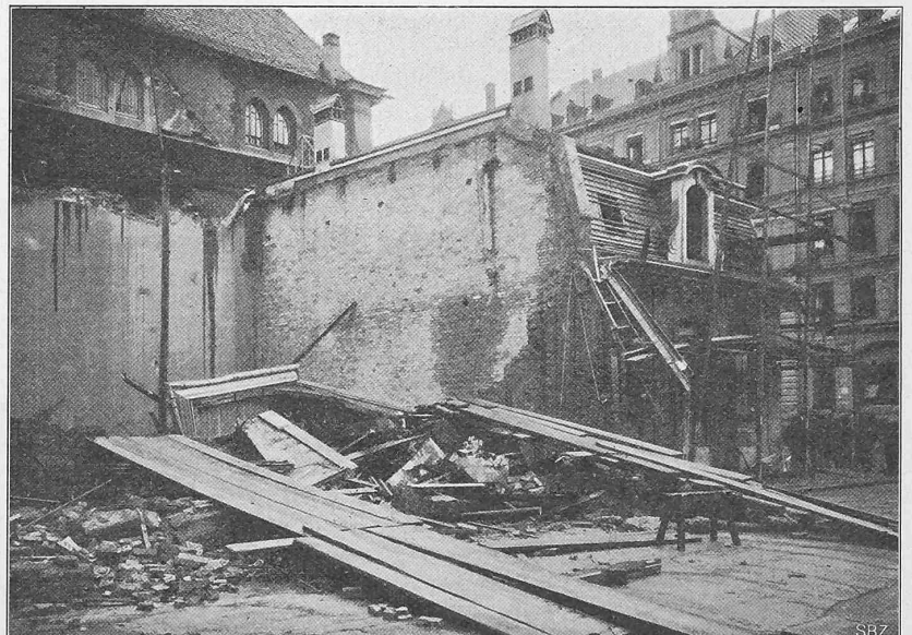
Abb. 4. Westliche Wand des eingestürzten Gebäudeteiles.
