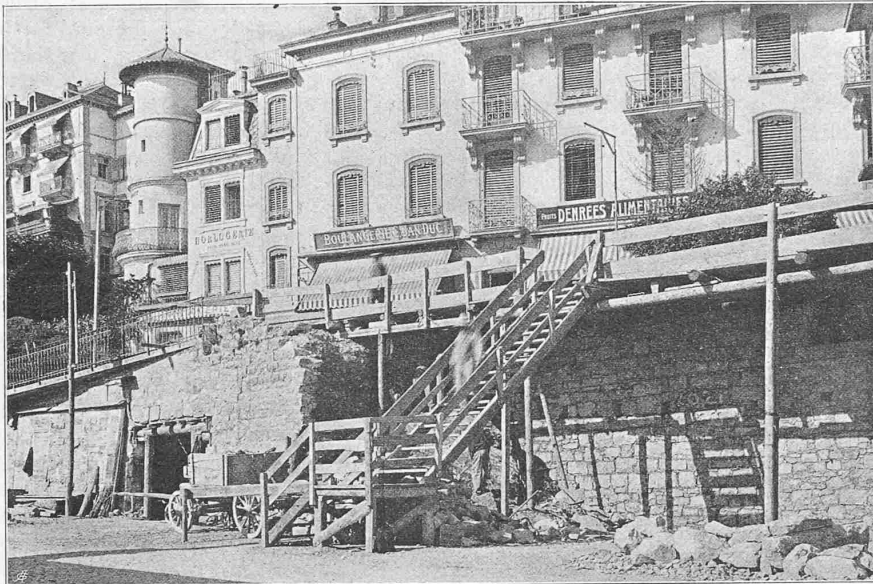
Abb. 5. Stollen für das linke Widerlager (B-B in Abb. 4) des Tunnels unter dem Hause Nr. 2.
