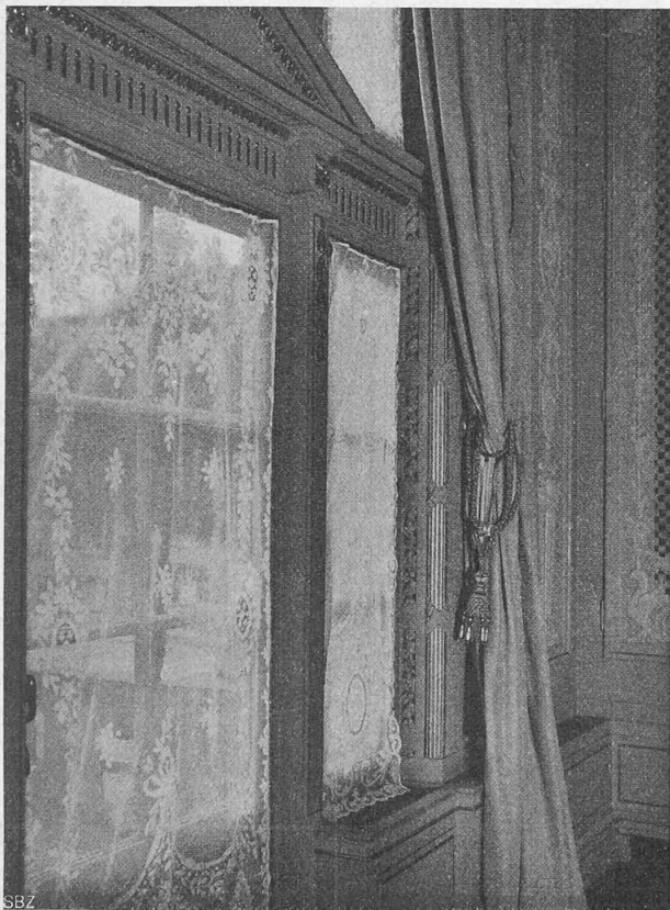
Abb. 32. Fensterheizung im Burgerratssaal des Berner Kasino.
