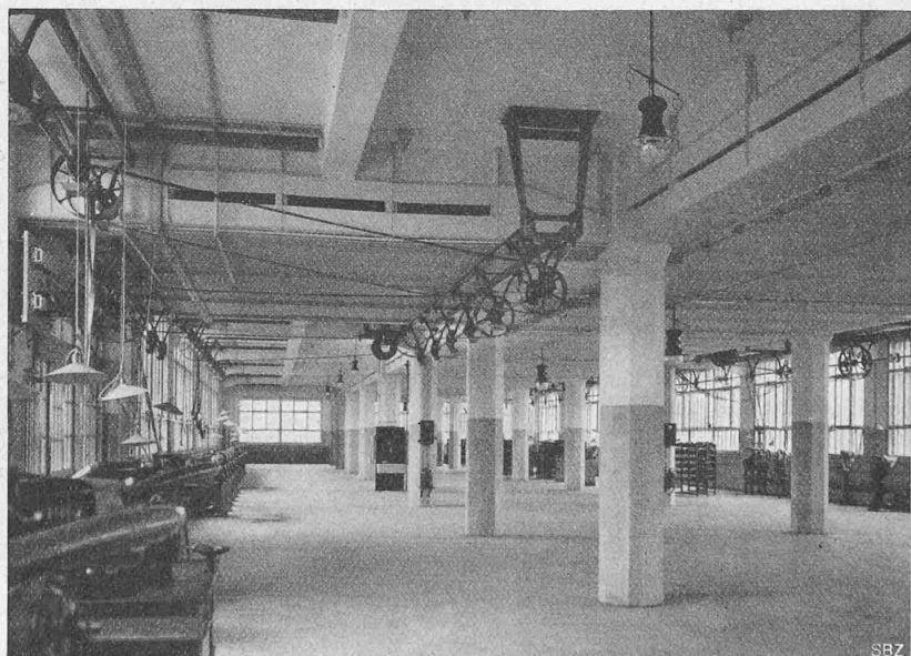
Abb. 20. Arbeitssaal im II. Stock mit Staubabsaugung und Frischluft-Zuführung.
