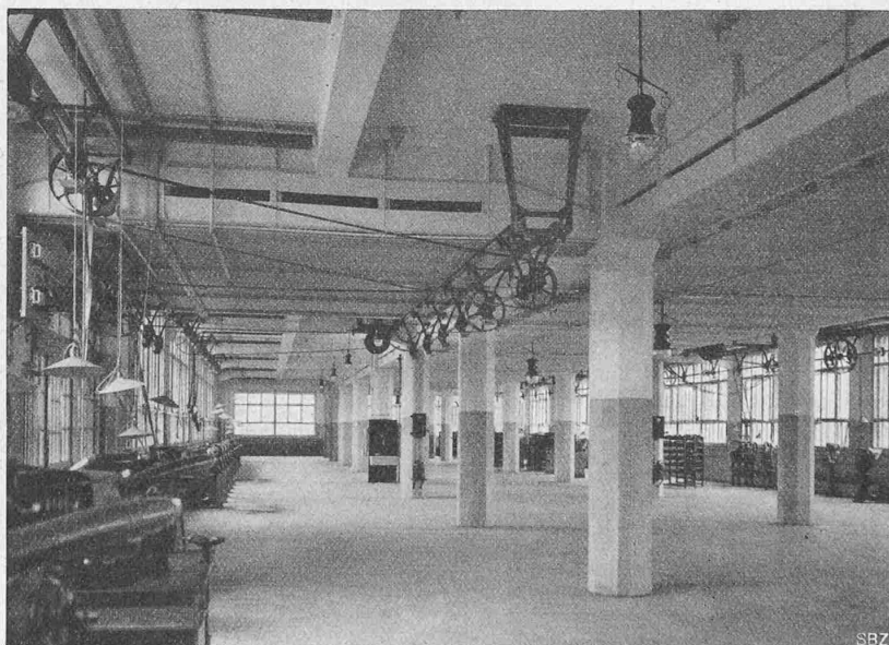
Abb. 20. Arbeitssaal im II. Stock mit Staubabsaugung und Frischluft-Zuführung.
