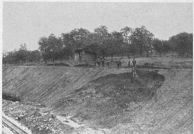
Abb. 1. Einschnitt-Rutschung bei Km. 17,500 der B.T.
