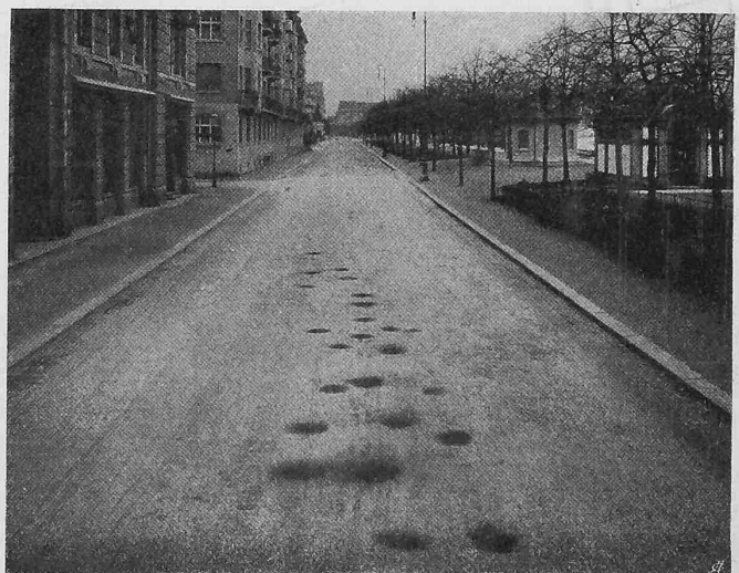
Abb. 2. Beschädigte Strassendecke aus Grauwackenschotter.
