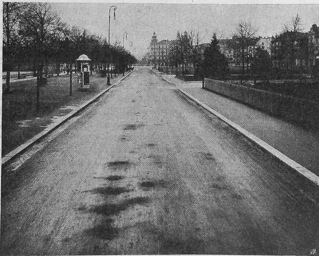
Abb. 1. Beschädigte Strassendecke aus Grauwackenschotter.
