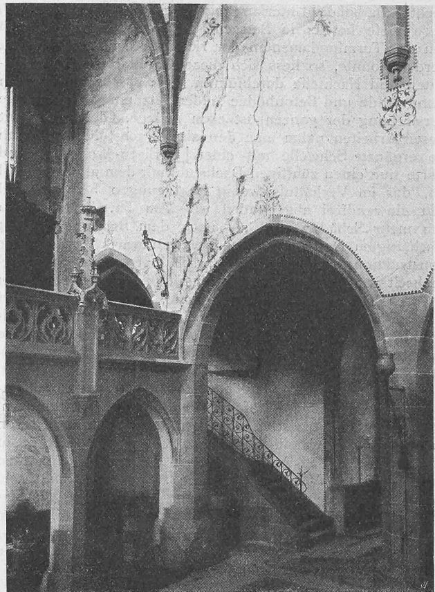
Abb. 17. Risse in der nördl. Längswand des Mittelschiffes. (Schnitt-Ebene a-b in untenstehender Abb. 20.)
