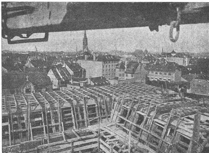
Neubau Lebensversicherungsgesellschaft „Bâloise“, Basel. Eisenbeton „System Züblin“: ca. 12000 qm Decken- und Dachkonstruktionen.
