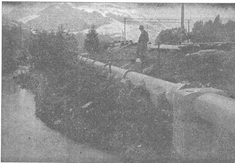
Wasserleitung der neuen Pulverfabrik in Wimmis, aus armierten Siegwart-Röhren von 400 mm Durchmesser.
