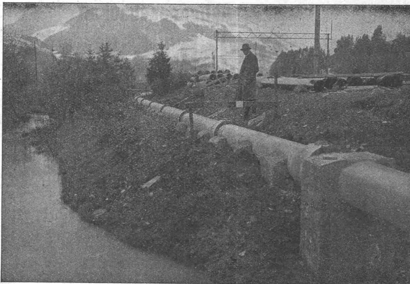
Wasserleitung der neuen Pulverfabrik in Wimmis, aus armierten Siegart-Röhren von 400 mm Durchmesser.
