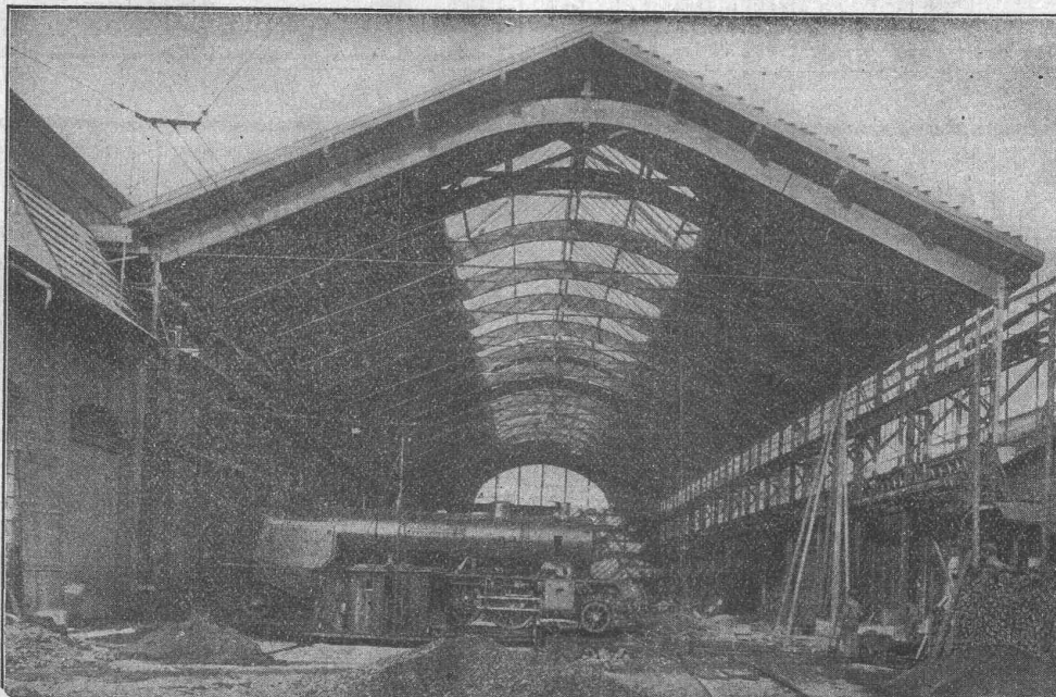
Montagehalle der Schweiz. Lokomotiv- und Maschinenfabrik Winterthur. Spannweite der Hetzerbinder 24 \frac{1}{2} m.
