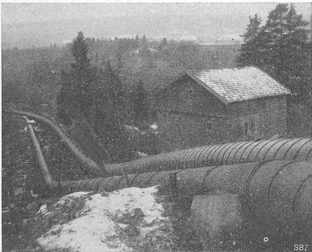
Abb. 6. Hölzerne Druckleitung (rechts) des Kraftwerkes Eidsvold, Durchmesser 1000 mm, Drukhöhe 48 m; zum Ersatz der links davon liegenden ältern Eisenrohrleitung.
