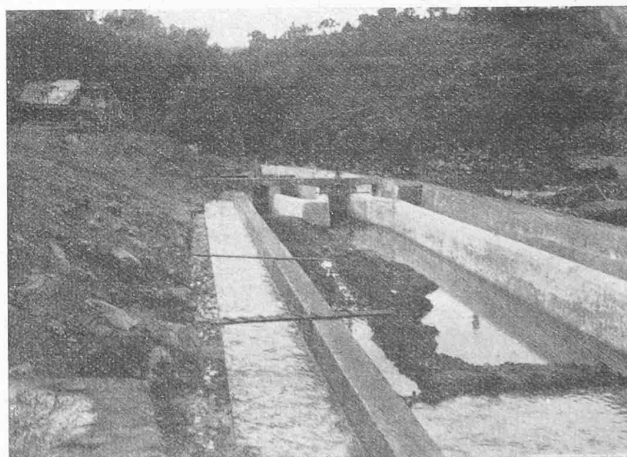
Fig. 4. Vue prise d'amont du bassin de décantation à vide. L'eau coule par le canal direct (à gauche).
