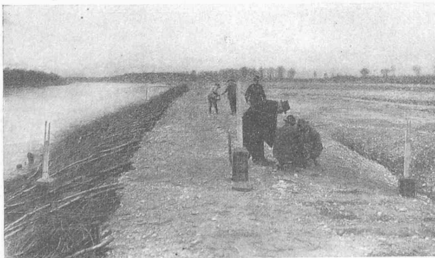
Abb. 1. Der provisorische Abschlussdamm, links der Rhein, rechts das Durchstich-Bett; im Vordergrund eine Minengruppe.
