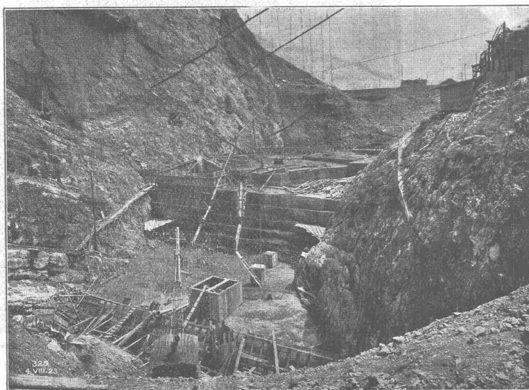
Staumauer Schräg des Kraftwerkes Wäggital. (Ausführung gemeinsam mit der Firma H. Hatt-Haller) Aufnahme vom 4. August 1923.
