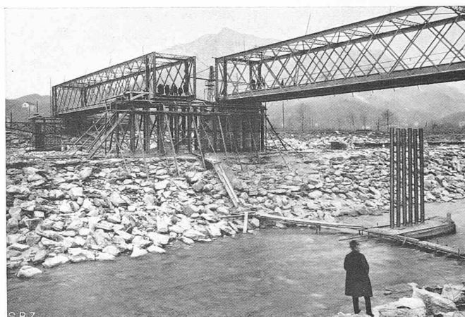
Abb. 4. Verschiebung der alten Brücke am 22./23. Febr. 1930, vom linken Ufer aus. Rechts die Stützen des Lehrgerüst-Pfeilers in der N-W-Rinne.
