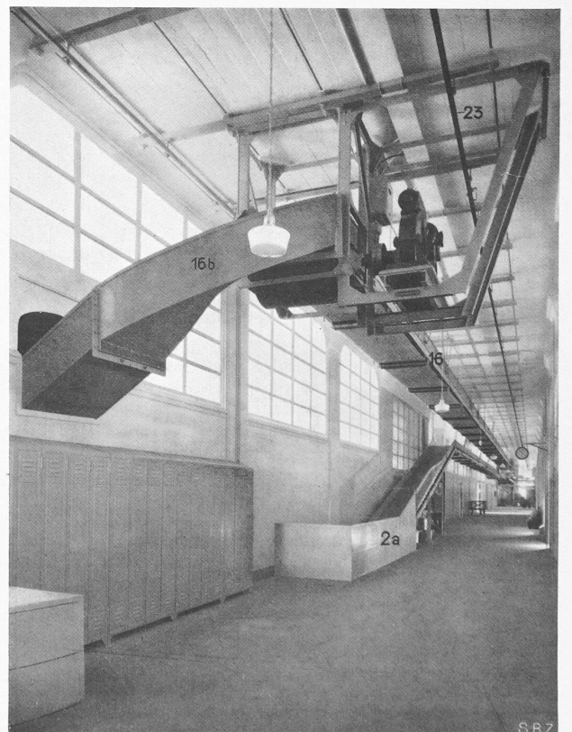
Abb. 27. Förderbänder und Hängebahn im Gang des Erdgeschosses.
