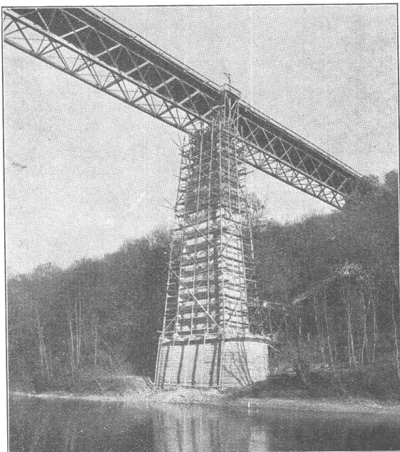
Umbau der S. B. B. Reussbrücke Mellingen. — Ausführung der Ummantelung der Pfeiler in Eisenbeton.
