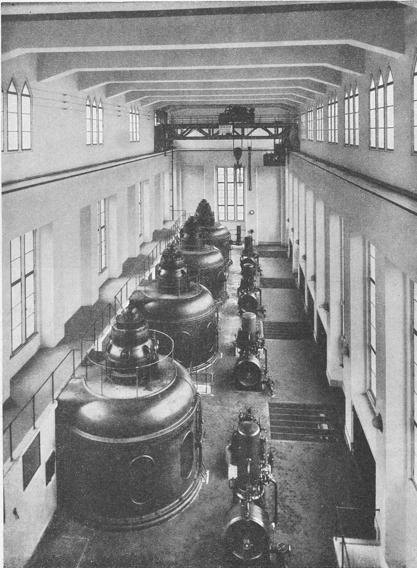
Abb. 68. Maschinensaal der Zentrale Siebnen.
