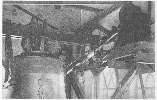
Abb. 4. Ansicht der Läutemaschine System Knell.
