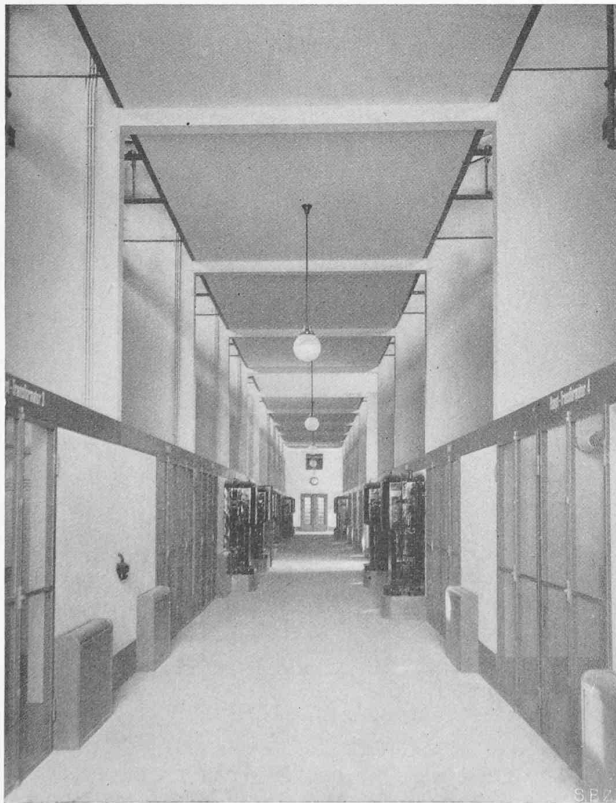
Abb. 47. Bedienungsgang der 10,5 kV-Hauptschaltanlage.
