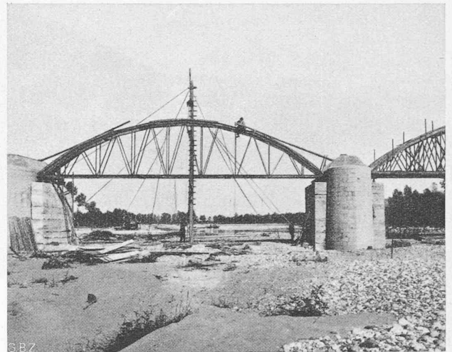
Abb. 18. Eisernes Lehrgerüst aus verschraubten Stabelementen zusammengesetzt, in erstmaliger Verwendung beim Bahnbau Asti-Chivasso (1911/12).
