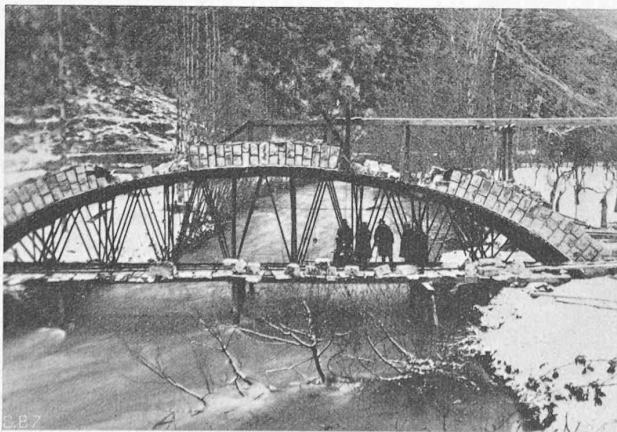
Abb. 20. Das selbe Lehrgerüst wie oben, für die Brücke über die Nera bei Km. 30 der Spoleto-Norcia-Bahn.
