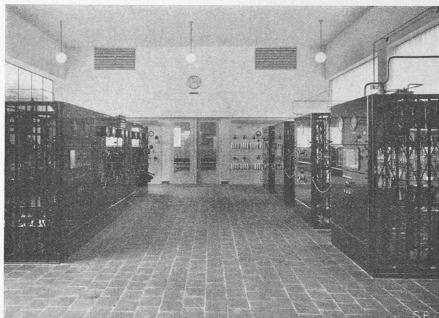
Abb. 7. Senderraum des Schweiz. Landessenders Sottens.
