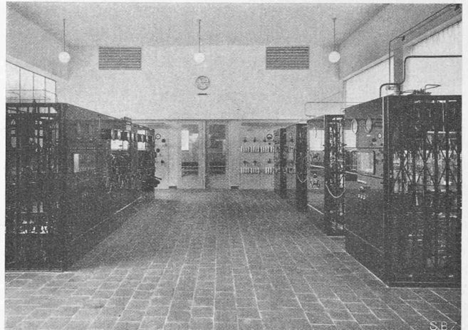
Abb. 7. Senderraum des Schweiz. Landessenders Sottens.
