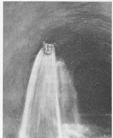
Abb. 8. Quellfassungen im mit Sika abgedichteten Stollen III-II, 330 m oberhalb von W III a.
