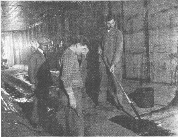
Interessante Isolierung eines Sole-Behälters
